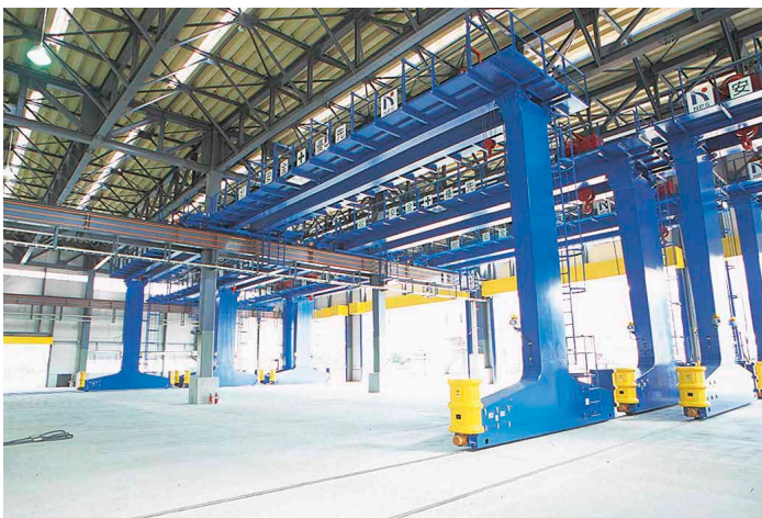
クレーン(片脚式橋型クレーン) ( 20t吊:4基・15t吊:4基・5t吊:4基 )
